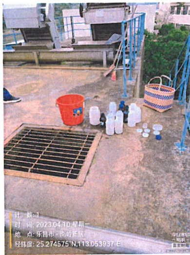
污水厂进水口
