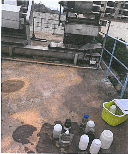
污水厂进水口
